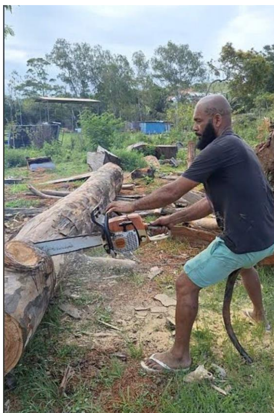
Figura 4 - Operador de motosserra sem EPI's
