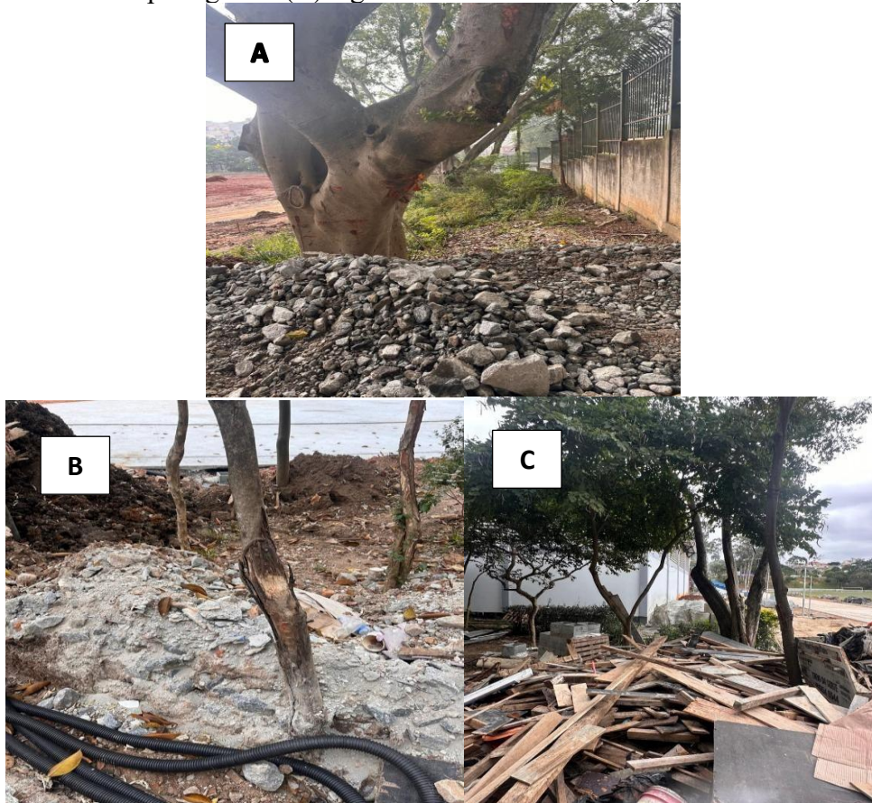
Figura 14 - Descarte inadequado, na base de árvores de ficus- benjamim (A), pitangueira (B) e goiabeira e alfeneiros (C), obra 1.
