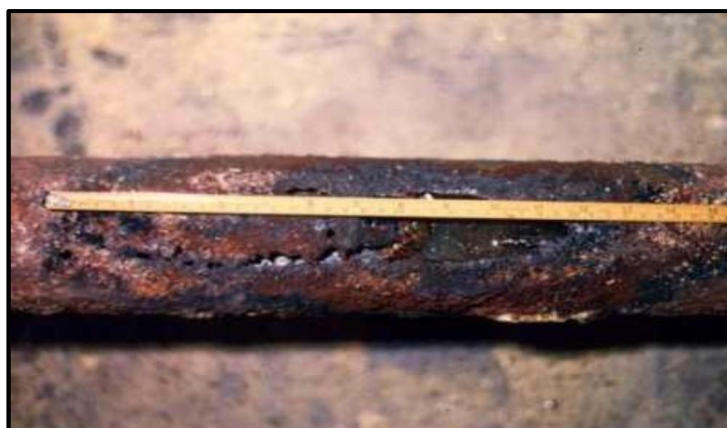
Figura 17 - Corrosão Grafítica que ocorre em Ferro Fundido - Teor maior que 2,11% de Carbono - caracterizada pelo aspecto escuro (carbono na forma de grafite).
