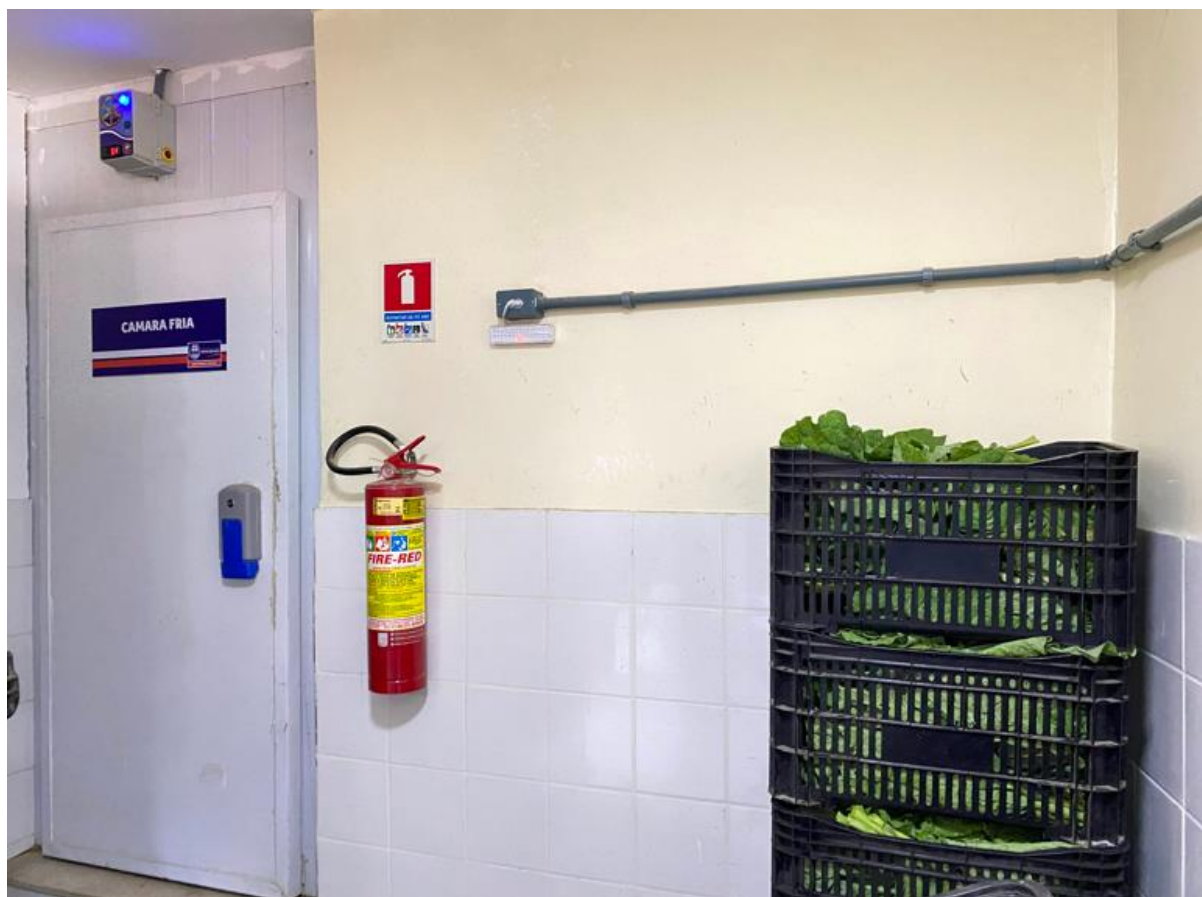
Figura 4. Câmara fria do Banco de Alimentos Laranjais (Nova Iguaçu-RJ).
