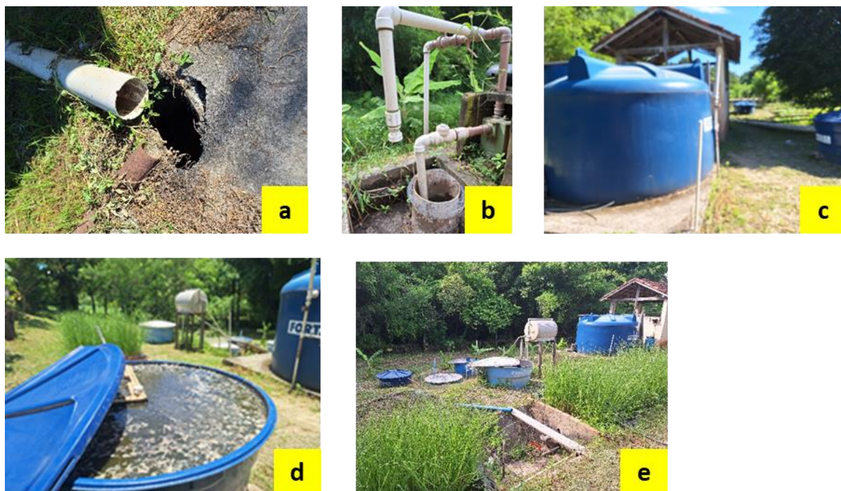
Figura 1. Esterqueira para acúmulo de ARB produzida no SIPA (a); bombeamento instalado com proteção de tubulação de sucção (b); tanque séptico (c, d, e)
