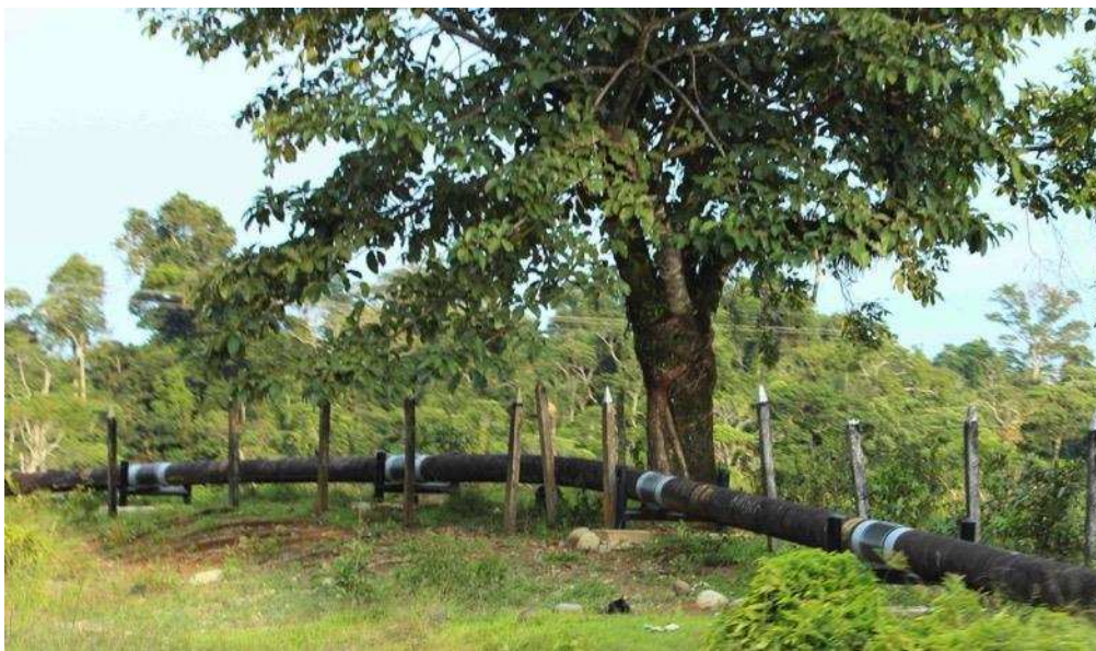
Fotografía 12. Oleoducto Transandino que recorre gran parte de la vía Orito-San Miguel. AZUERO 2013, San Miguel, Putumayo.
