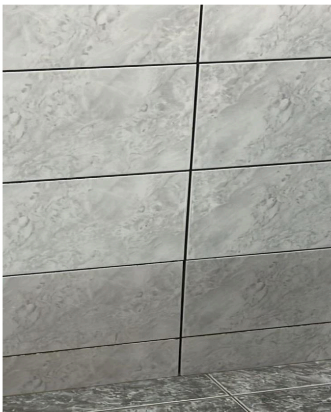
Figura 10 - Marca do nível da água (inundação)
