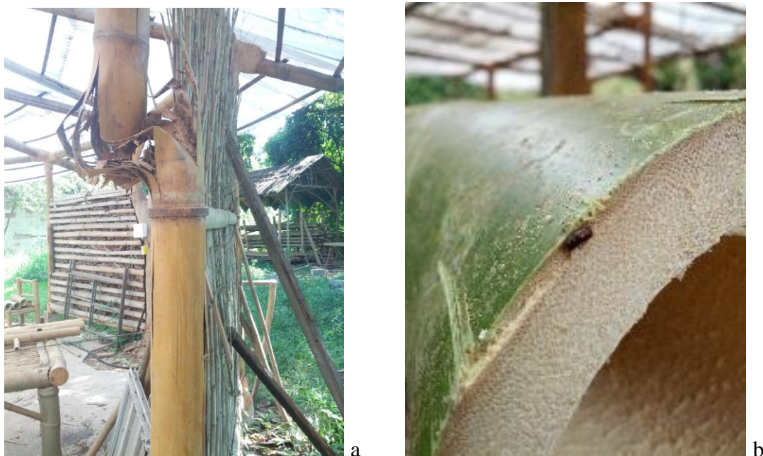
Figura 4: a) Ruptura de uma coluna ocorrido devido a ação de insetos. B) ataque de Dinoderus minutus em Bambusa vulgares . (fotos: Ivan lobo)
