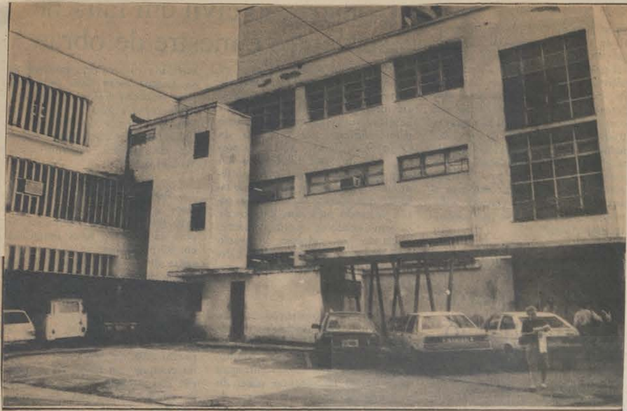
Nas paredes externas são visíveis as rachaduras que põem em perigo toda a construção.
