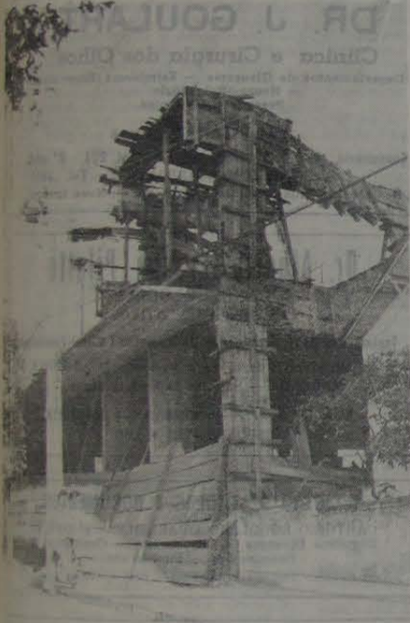
O madeirame do inacabado Edifício Falcão pode desabar a qualquer momento.
