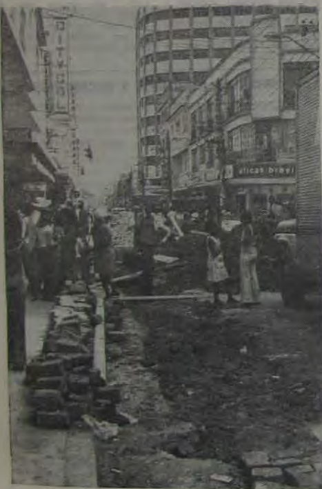
Na foto vemos uma das ruas do Centro da cidade que sofre profunda reforma em seu sistema original de condução de água, esgoto, condutos elétricos e telefônicos. Trata-se da Av. Gov. Amaral Peixoto, que dentro em breve estará totalmente urbanizada, com seu calçadão para pedestres totalmente concluído dentro de 120 dias, no máximo.
