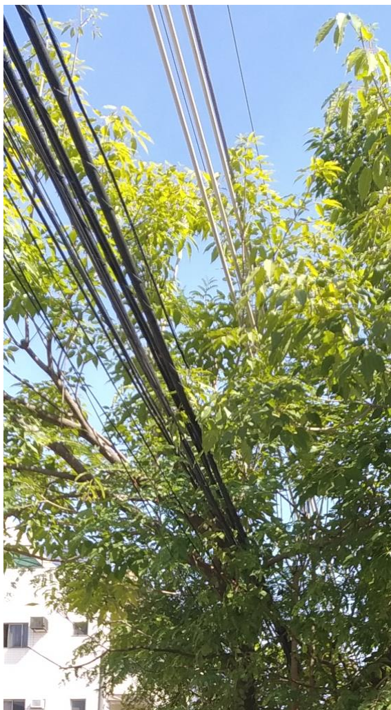
Figura 9. Conflito da parte aérea de um indivíduo de Ipê Roxo com fiações de redes domésticas e baixa tensão, localizado na Rua Júlio Porto Carrero, Freguesia. Fonte: Arquivo Pessoal.
