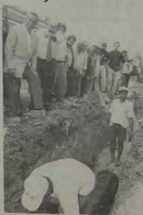
Os operários, em presença do Governador Marcelo Alencar e da Secretária de Obras e Serviços Públicos, Luiz Paulo Corrêa da Rocha, instalando tubulação de água, de 40 centímetros de diâmetro, num trecho da Av. Edison, entre a Travessa Souza e a Estrada da Carioca, no bairro do Rocha, em São Gonçalo.
