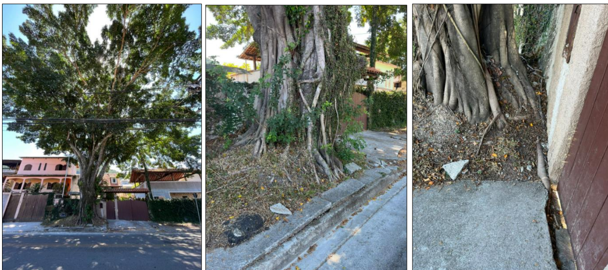
Figura 11: Figueira-Chorão ( F. benjamina ) em proximidade ao muro da residência adjacente, apresentando raízes danificando o calçamento e gerando transtornos aos moradores da área próxima. - março/2023
