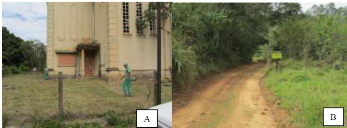
Figura 6. A:Subestação elétrica isolada com tijolos nas janelas e portas, além de cerca. B: Placa indicando acesso restrito.
