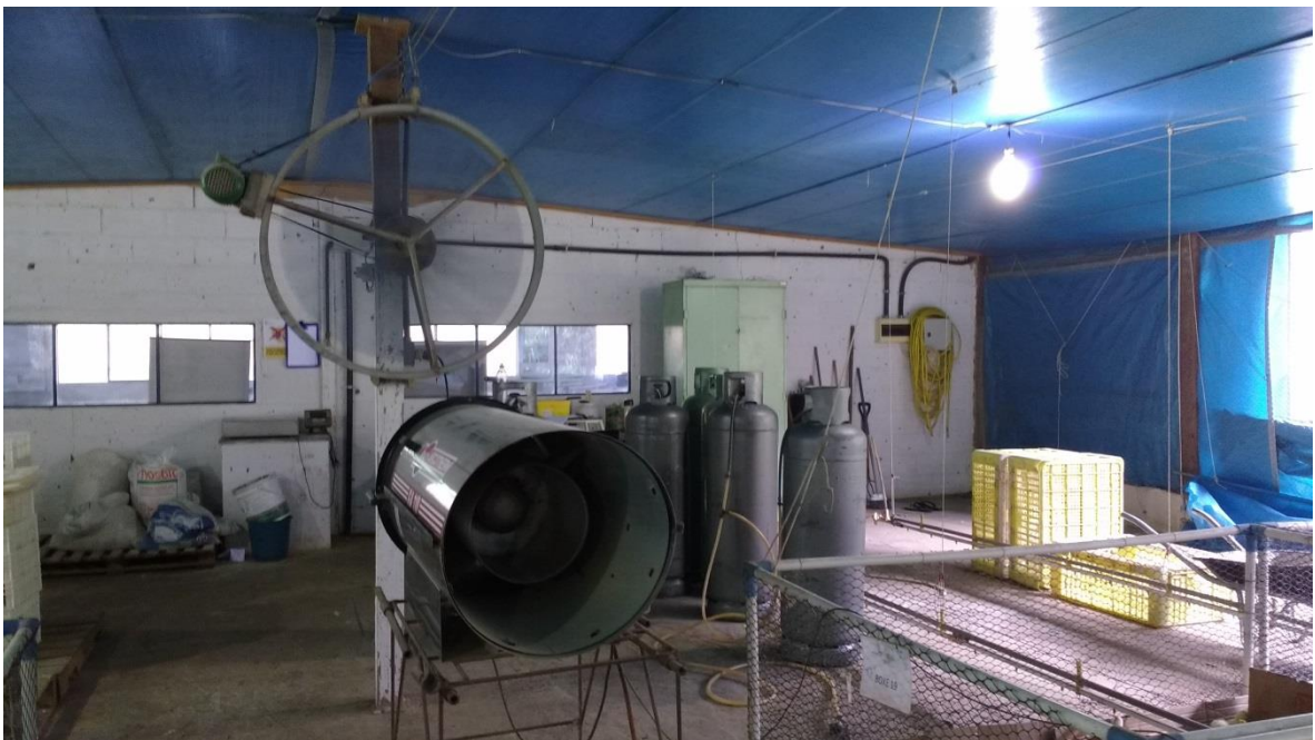
Figura 3 - Sistema de aquecimento e ventilação do galpão experimental do Centro de Pesquisa Avícolas do IFRJ.
