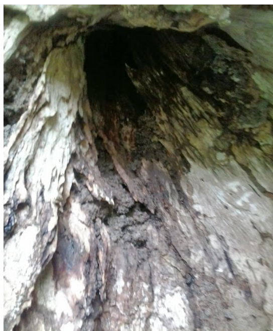
Figura 22. Sinais de danos causados por cupins.
