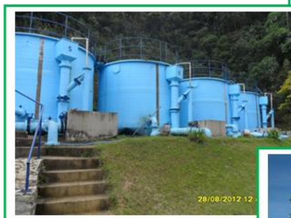
Estação Tratamento Água - Mosela
