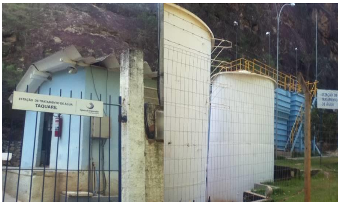
Figura 21. Estação de Tratamento de Água do Taquaril.
