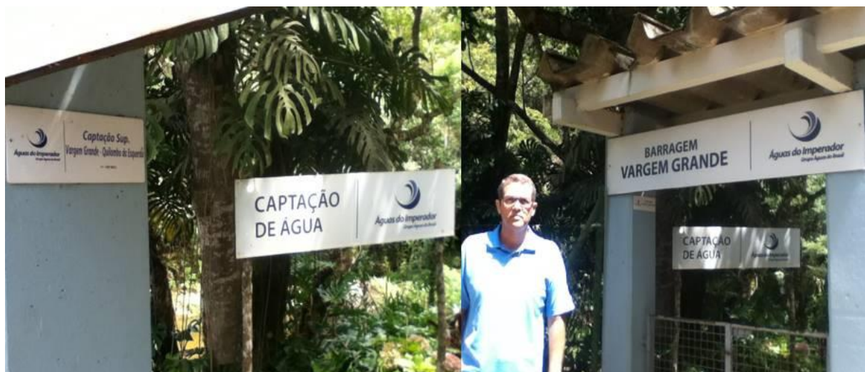
Figura 22. Estação de Captação de Água da ETA Mosela (região do bairro do Rocío)
