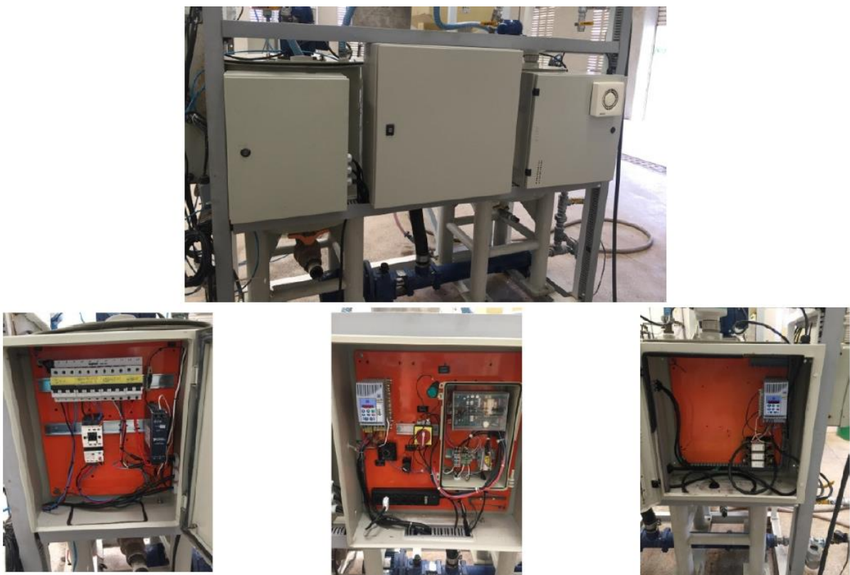
Figura 34. Quadros de comando e força da unidade experimental (acima) e seus interiores (abaixo).
