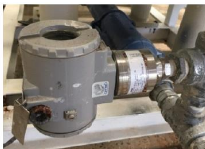
Figura 28. Transmissor indicador de Pressão (PIT-04).
